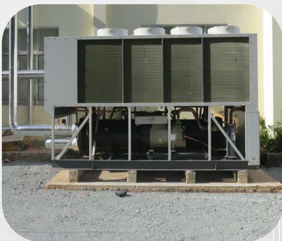
Chiller giải nhiệt gió/ Chiller Air Cooling
