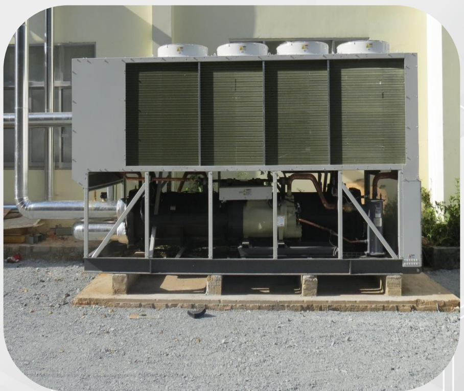
Chiller giải nhiệt gió/ Chiller Air Cooling
