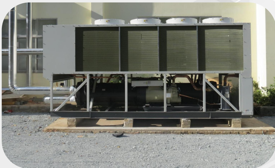
Chiller giải nhiệt gió/ Chiller Air Cooling
